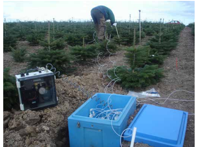
Installation af jordsonder til at opfange nedsvinningsvand under træernes rodzone (t.v.). Indsamlet jordvæske (t.h.). Clausholm, marts 2007.
